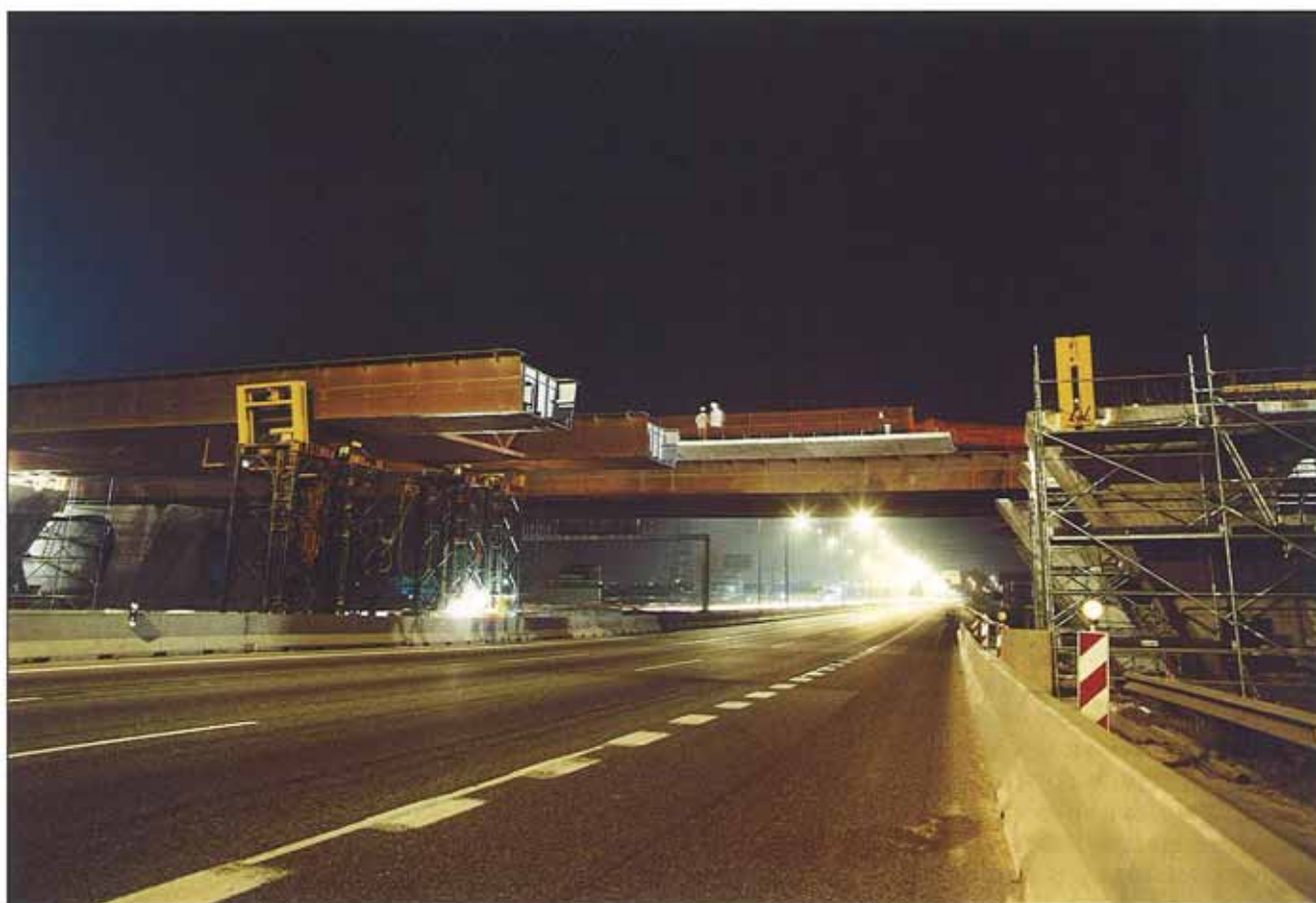
Estructura mixta de 130 m de longitud con un vano central de 60 m de luz.
