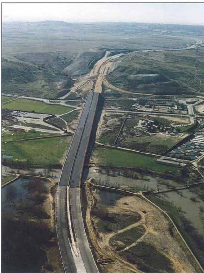
El tramo tiene una longitud de 14,7 km con 3 carriles por sentido de la circulación.
