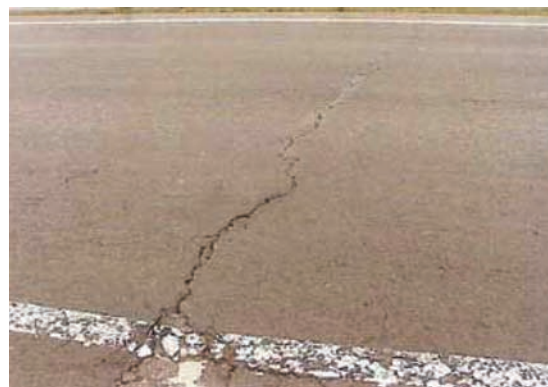
Fisura transversal reflejada en superficie.
