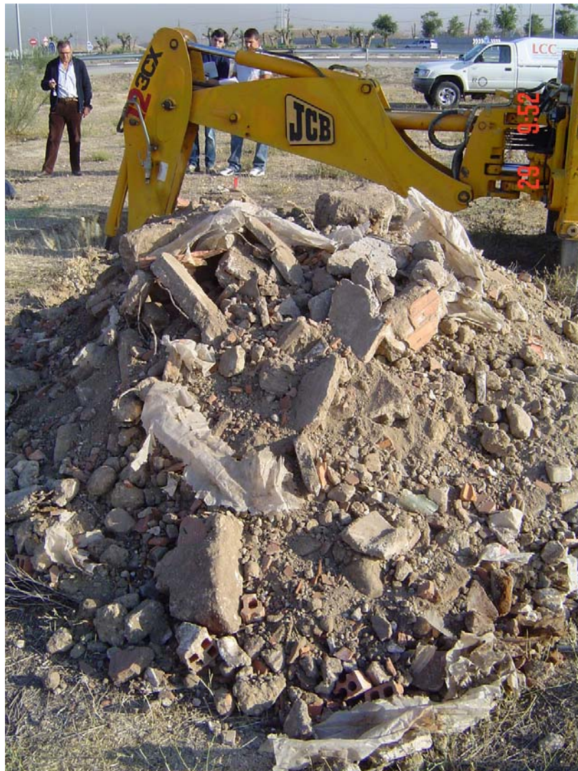
figura 5: Vista del montón de una de las catas realizadas en la campaña geotécnica complementaria con mayor porcentaje de cascotes
