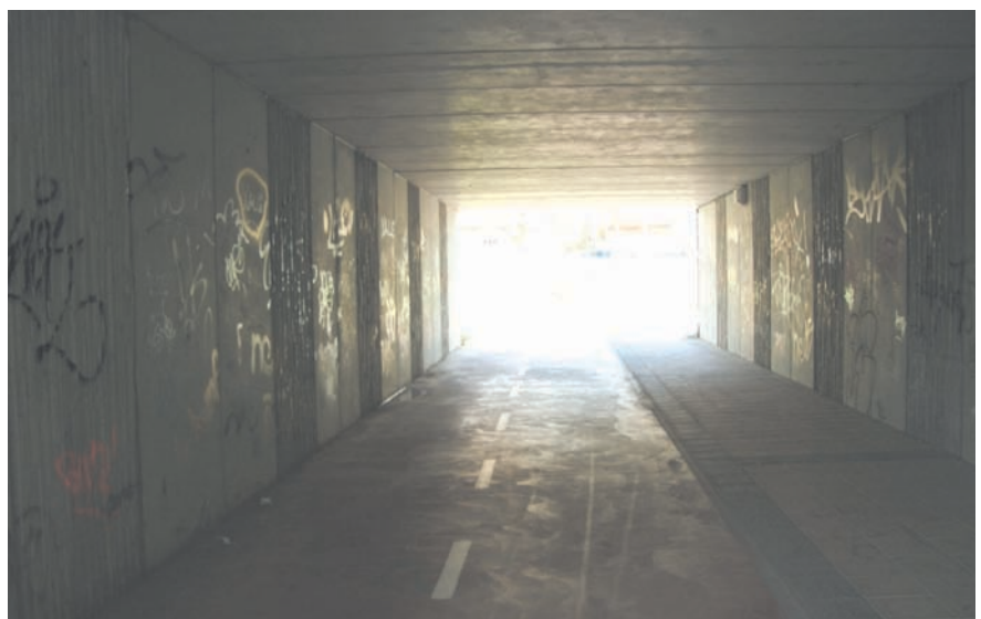
Foto 24. Soluciones en túneles.
