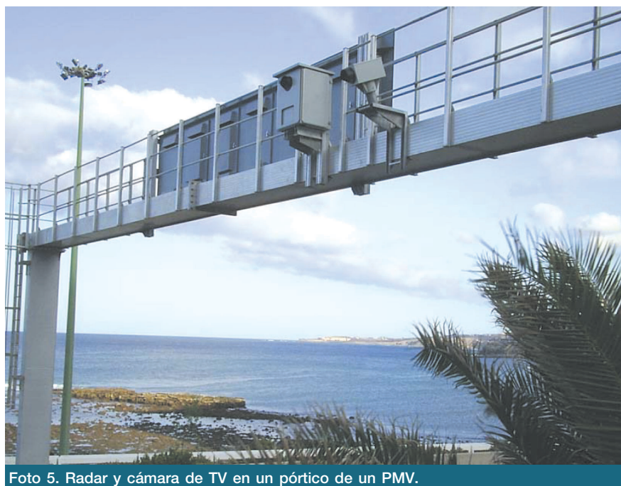
Foto 5. Radar y cámara de TV en un pórtico de un PMV.
