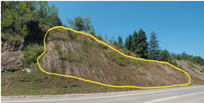
Talud izquierdo-Sector IIIb (foto 21)
