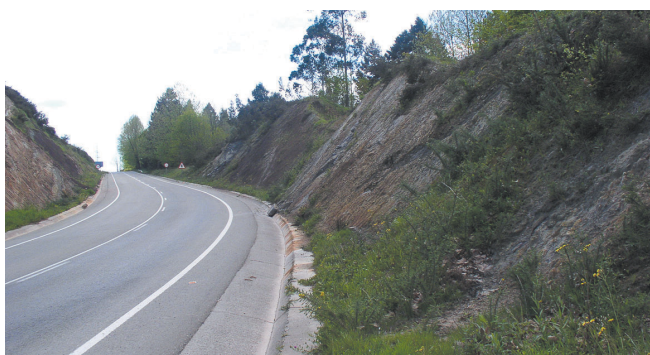
Foto 1.-Desmorte derecho previa la realización de la hidrosiembra (2 mayo 2007).
