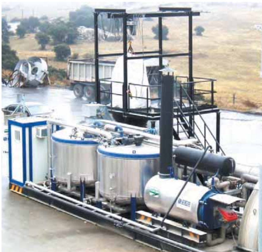
Foto 3. Instalación de fabricación de betún con polvo de neumáticos
