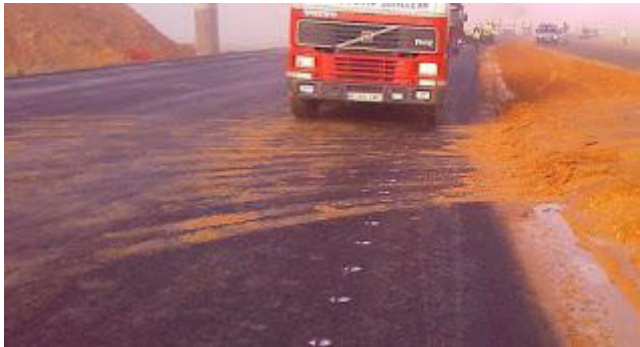
Figura 15. Tierra adherida al pavimento Fuente: Blog Motores y carreteras
