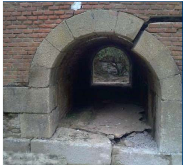
Detalle de arcos dañados
