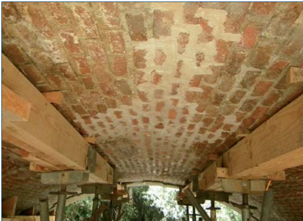
Llagueado de la fábrica de ladrillo
