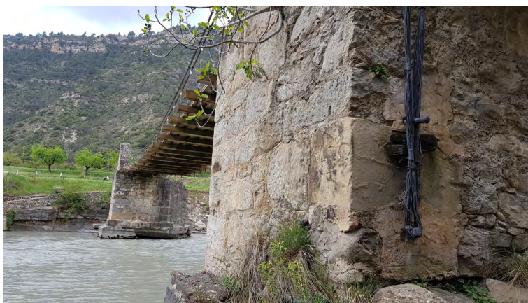
Fotografía 3. En primer plano detalle del anclaje de un cable principal a la pila
